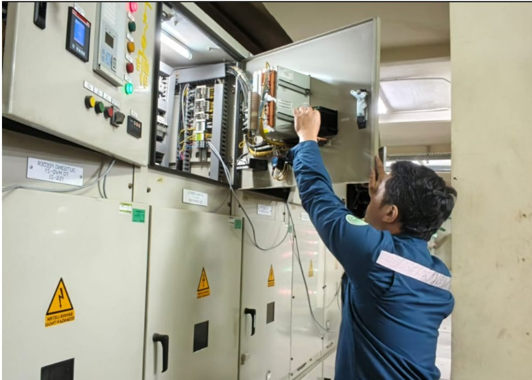
Gambar 2. Terminasi RJ485 perangkat ANR96 pada panel MVD11#9
